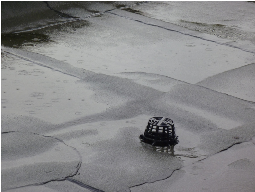
Zu hoch eingebauter Dachgully, Flicker und Pfützen auf dem Flachdach
